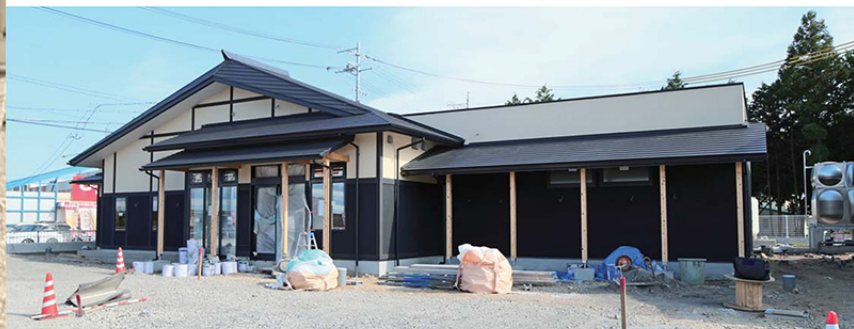
(図VI) 現在施工中の現場外観。職人さんから問われた屋根納まりなどもノートパソコンを開き、3Dパースを様々な角度から見せることで作業が捗る。現場こそBIMの力が発揮される。
